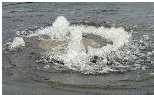
Bei Starkregen entsteht oft ein Staudruck im Kanalnetz. Dadurch können Deckel von Schachtabdeckungen angehoben oder gar weggeschwemmt werden
