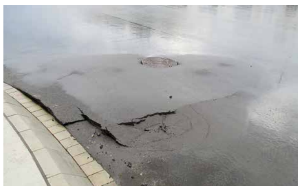
Mangelnde Druckentlastung und/oder Leckagen unterhalb der Schachtabdeckung können zu schweren Schäden am und um das Schachtbauwerk führen.
