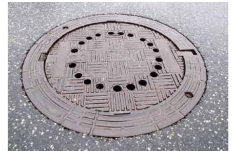
Deckel liegt abgesunken im Rahmen
