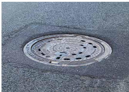
Besser nicht so: Im Asphalt eingesenkener einwalzbarer Rahmen, Setzung von Deckel im Rahmen © Foto: GET
