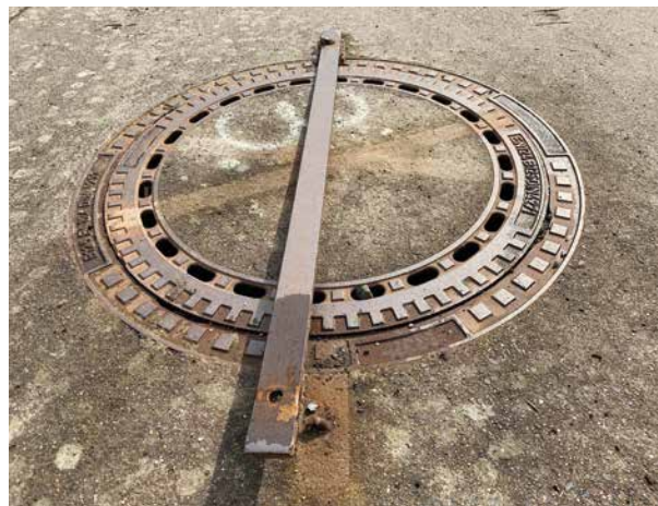
„Kreative“ Deckelsicherung: Ein geeigneteres Produkt wäre sicher verfügbar gewesen! © Foto: GET
