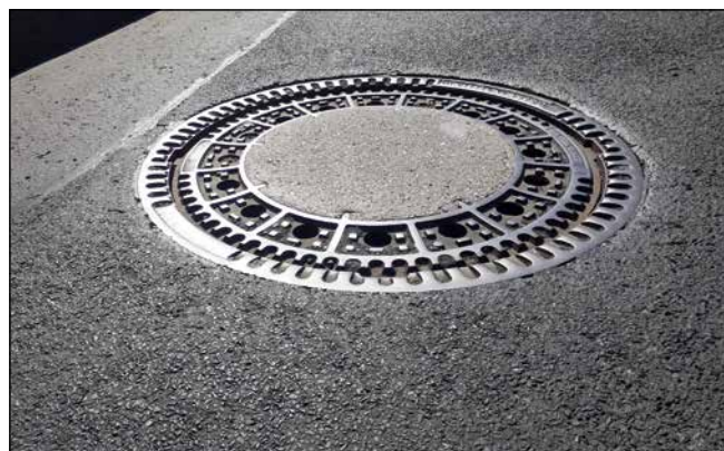
Abgesunkener Deckel im Rahmen, da nur eine Einlage verwendet wurde. Dies kann zu Verschleiß und Absinken des Deckels führen.
